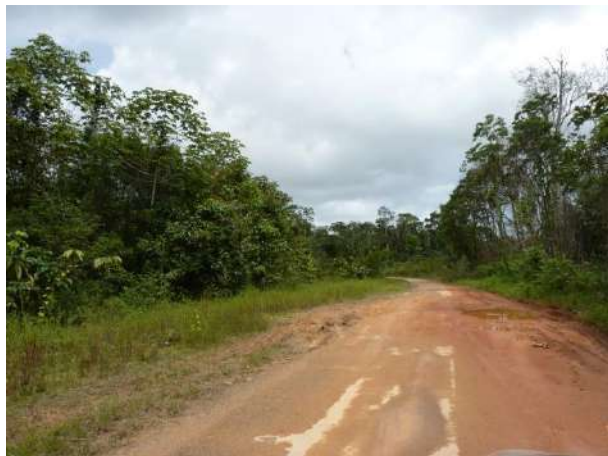
Figure 52: Accotement enherbé et route en mauvais état
