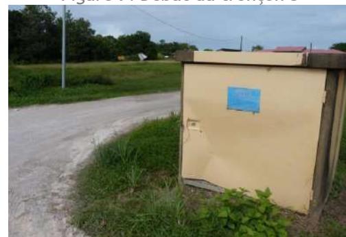
Figure 8: Poste électrique EDF
