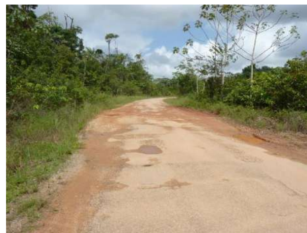
Figure 51: Elargissement, route en mauvais état
