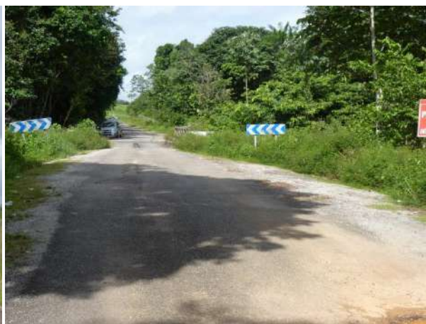
Figure 29: Accotement avant pont
