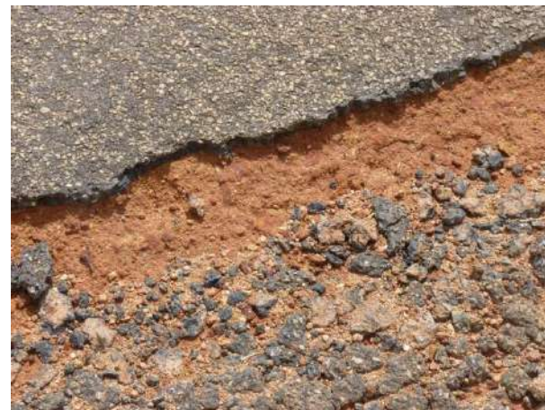
Figure 49: Etat de l'enrobé
