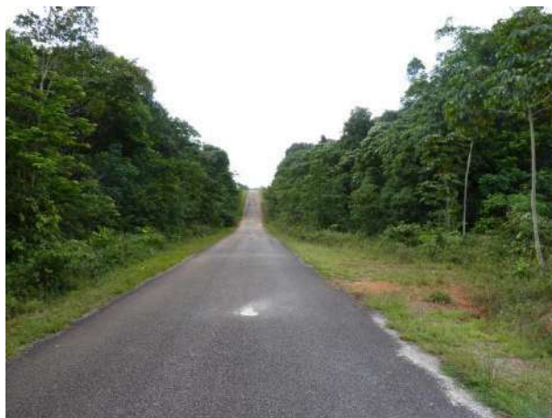
Figure 22: Accotement prononcé sur la droite
